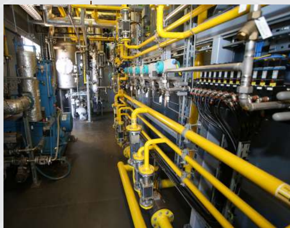
Unidade de beneficiamento de biogás
